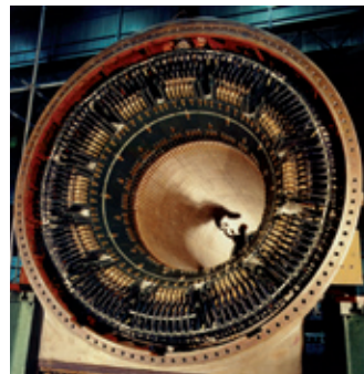
Faseroptische Sensoren in Kraftwerksgeneratoren (Feldversuche) (Bild: LHFT, Erlangen)
